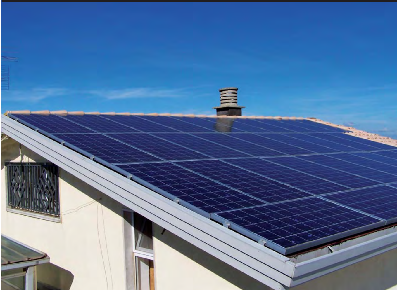
Esempio di impianto fotovoltaico installato a tetto
