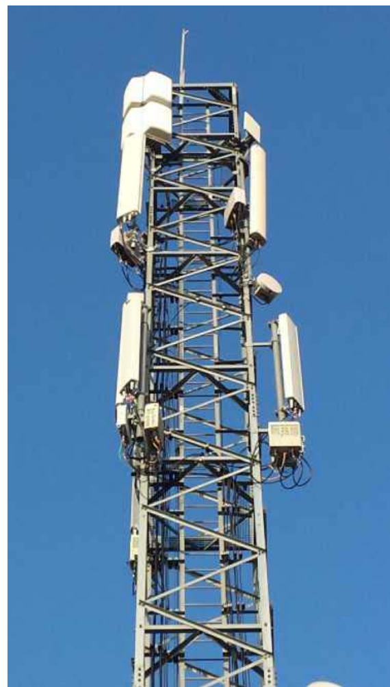
Antenna per telecomunicazioni
