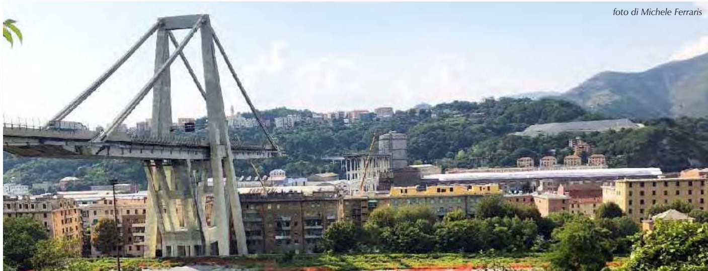
I tronconi superstiti del Ponte Morandi dopo il crollo (GE)
